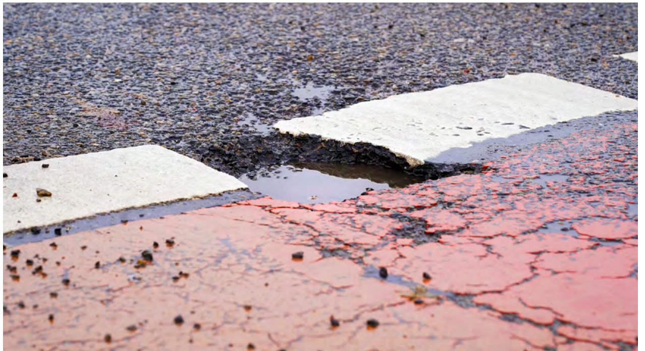
Schlaglöcher, wie das im Bild zu sehende am Falkeplatz, können über den Mängelmelder der Stadt Chemnitz angezeigt werden. Dann kümmern sich die Mitarbeitenden des Bauhofs so schnell wie möglich um die Ausbesserung. Foto: Philipp Köhler
