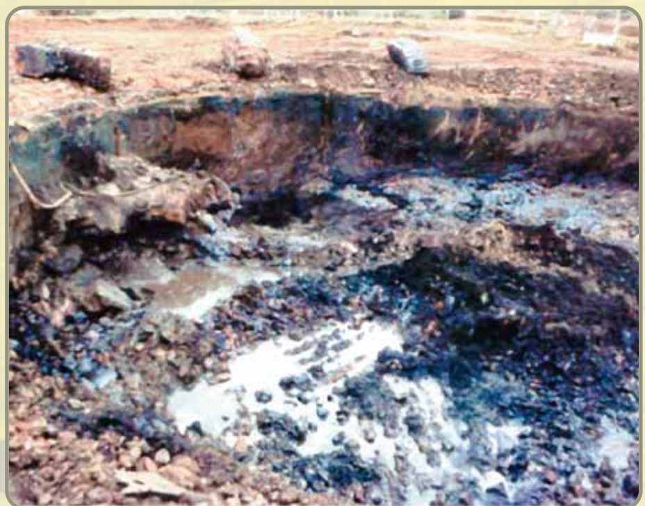
Abb. 19: Gasometer mit teerölkontaminiertem Bauschutt
