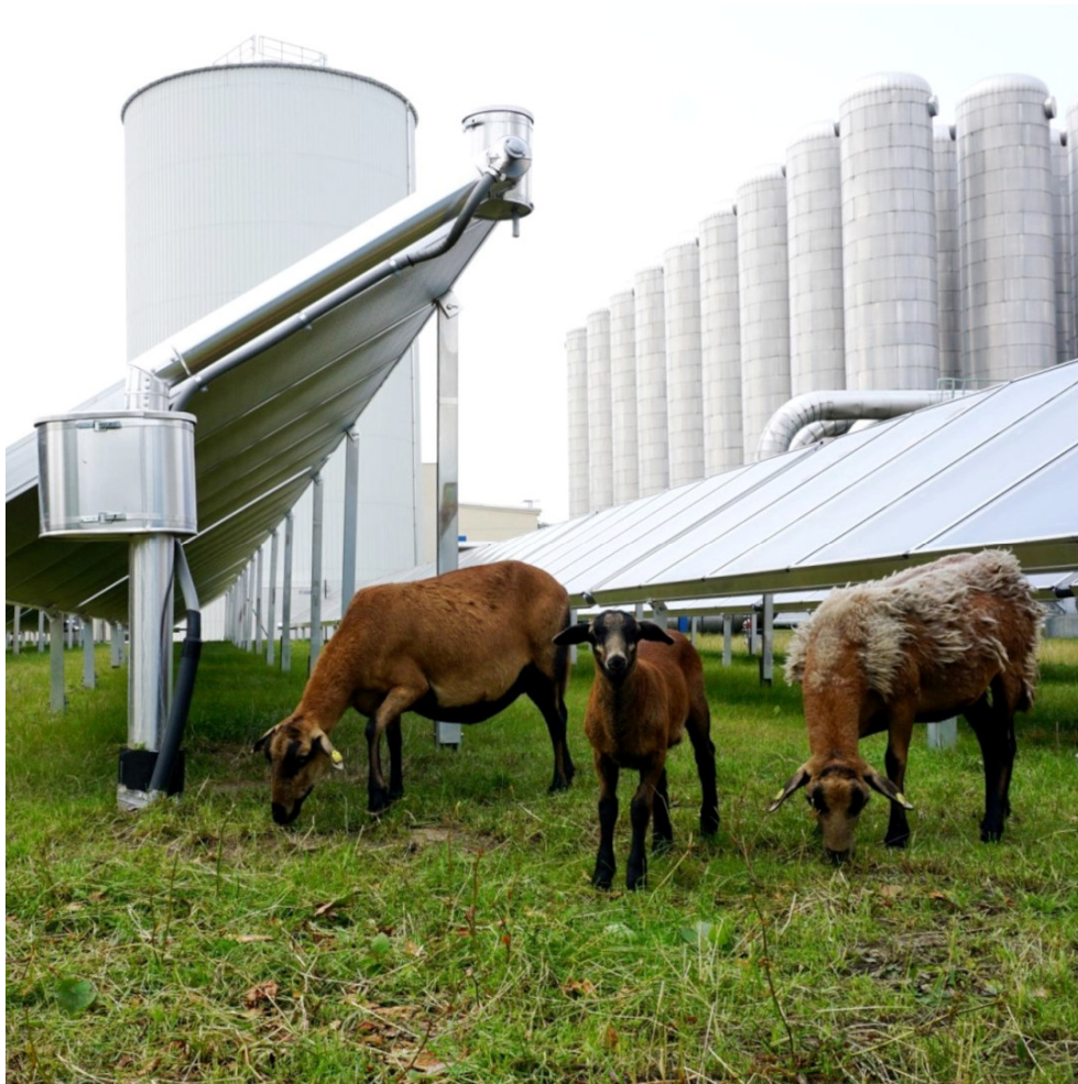
Abb. 1: Großsolarthermie-Anlage der eins, Brühl
